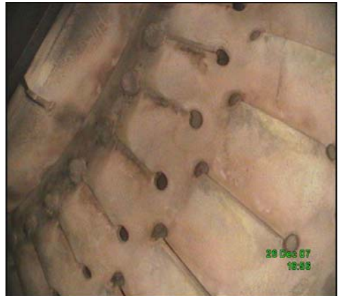
KOMORA SAGORIJEVANJA, deflektori – pojava oksidacije, hemijske korozije, djelimično progrijevanje bez oštećenja
