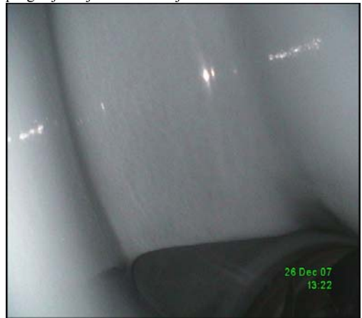
UVODNIK VAZDUHA – bez oštećenja
