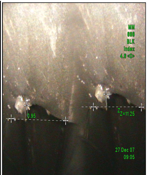
IZMJERENI RIS OŠTEĆENJA (mjereno sa druge strane) iznosi 0,95 mm
