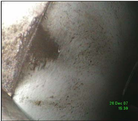
KUĆIŠTE CENTRIFUGALNOG KOMPRESORA – pojava korozije i nečistoće
