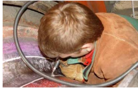
7d. iskivanje zavora pneumatskim čekićem sa ciljem relaksacije zaostalih napona od zavarivanja
