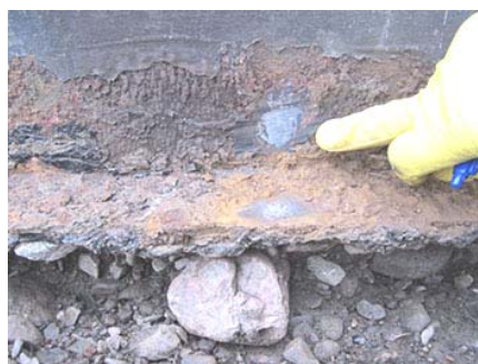
Slika 3. Primjer lokalne degradacije korozijom spoja plašt-podnica
