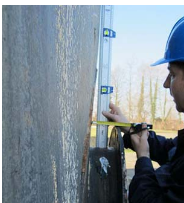
Slika 4. Primjer VT ispitivanja deformacija plašta
