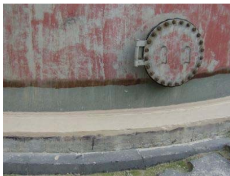
Slika 9. Primjer lokalnih popravki primjenom metalnim česticama ojačanih epoksi premaza [11]
