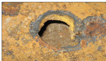
Slika 2. Primer korozije gasovoda uzrokovane lutajućim strujama
